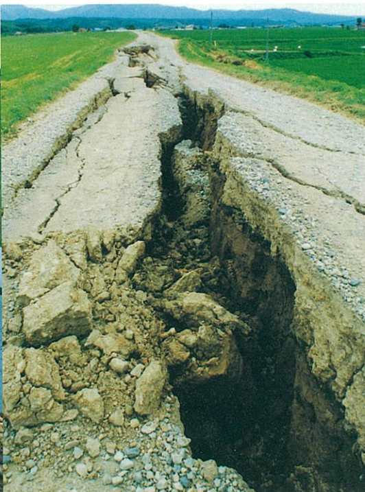
後志利別川北桧山町真栄橋上流左岸 上流方向を見る
