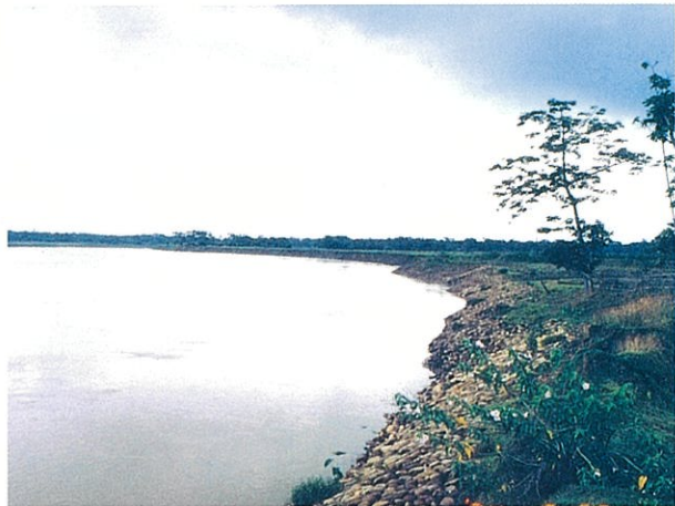
▲浸食対策(蛇籠による護岸例)
