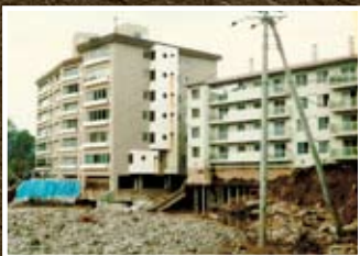
基礎が顕わになったマンション（札幌市南区）
