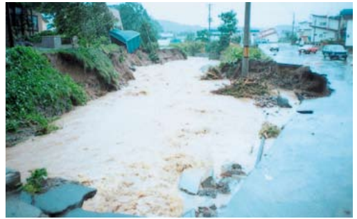
豊平川支川の南の沢川流域（札幌市南区）で道路が決壊
