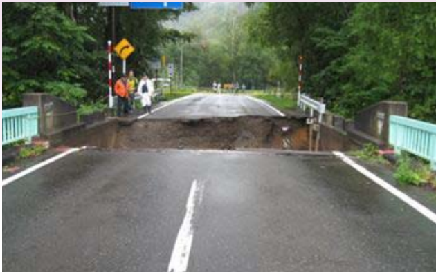
旭川旭岳温泉線（上忠別橋）。橋台背面の盛土が濁流に浸食され道路が決壊した
