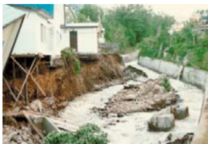
豊平川上流域での土砂流出による家屋被害（昭和56年8月下旬）
