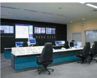
消防防災指令センター 発信地表示システムや車両の位置管理システムの導入により、さらに迅速な対応が可能に。
