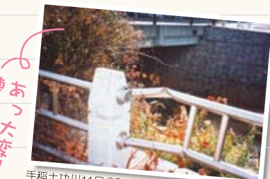
手稲土功川11月分「防護パイプが破損している。他の地点のパイプ外れは直っていた」
