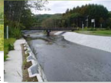
日高門別川の復旧状況
