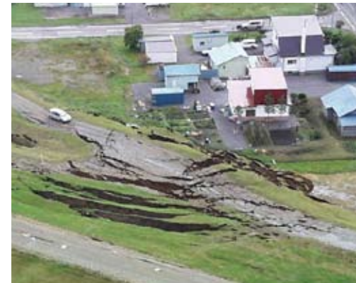
被災状況【十勝川 右岸 河口から3.5km付近】
