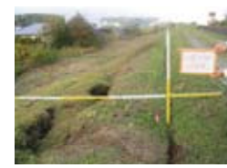
被災状況【浦幌十勝川 左岸 0.8km付近】
