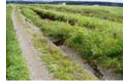
被災状況【清見布川(右狩川水系) 右岸 合流点から6.8km付近】
