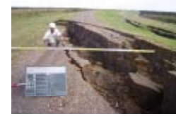
被災状況【十勝川 右岸 河口から5.0km付近】
